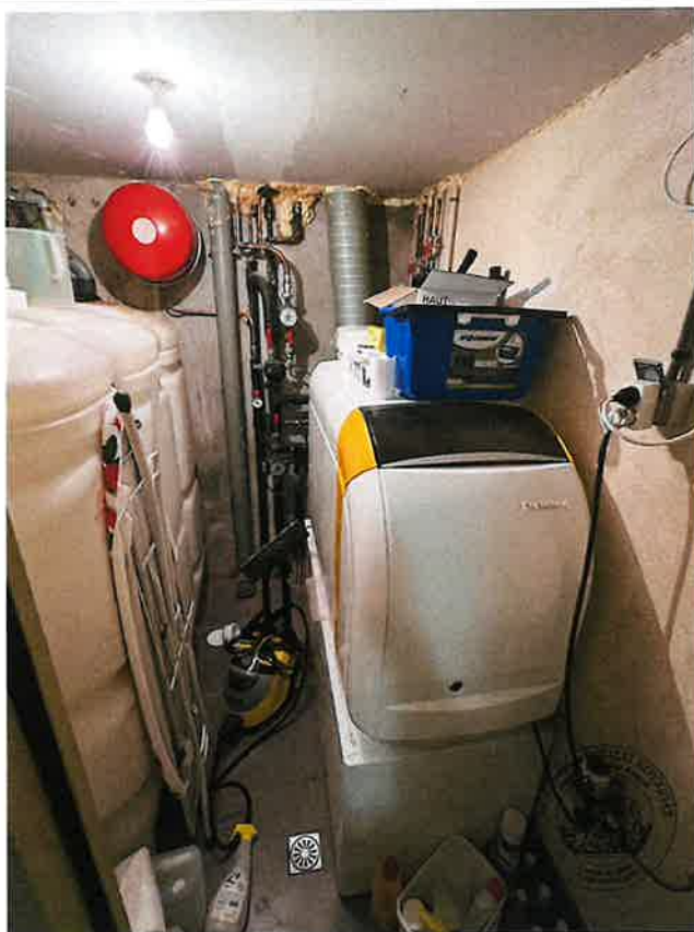
Chaufferie 4,25 m 2 : carrelage au sol, murs bruts et peints, placo au plafond. Une chaudière Fioul condensation 2009 puissance 38Kw De Dietrich et une cuve à Fioul. Ballon 250L.
